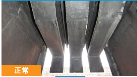
止水ゴムクラック
