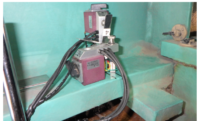
応力聴診器 設置状況
