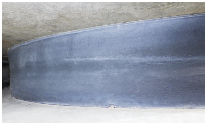
ゴム支承のクラック調査
