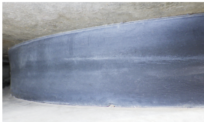
ゴム支承のクラック調査
